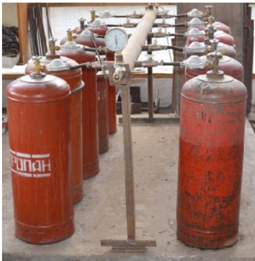
Рис.15. Газовая рампа на 10 баллонов 50 л пропан-бутановой смеси для газоснабжения камер ТМД «Энергия ТМ».
