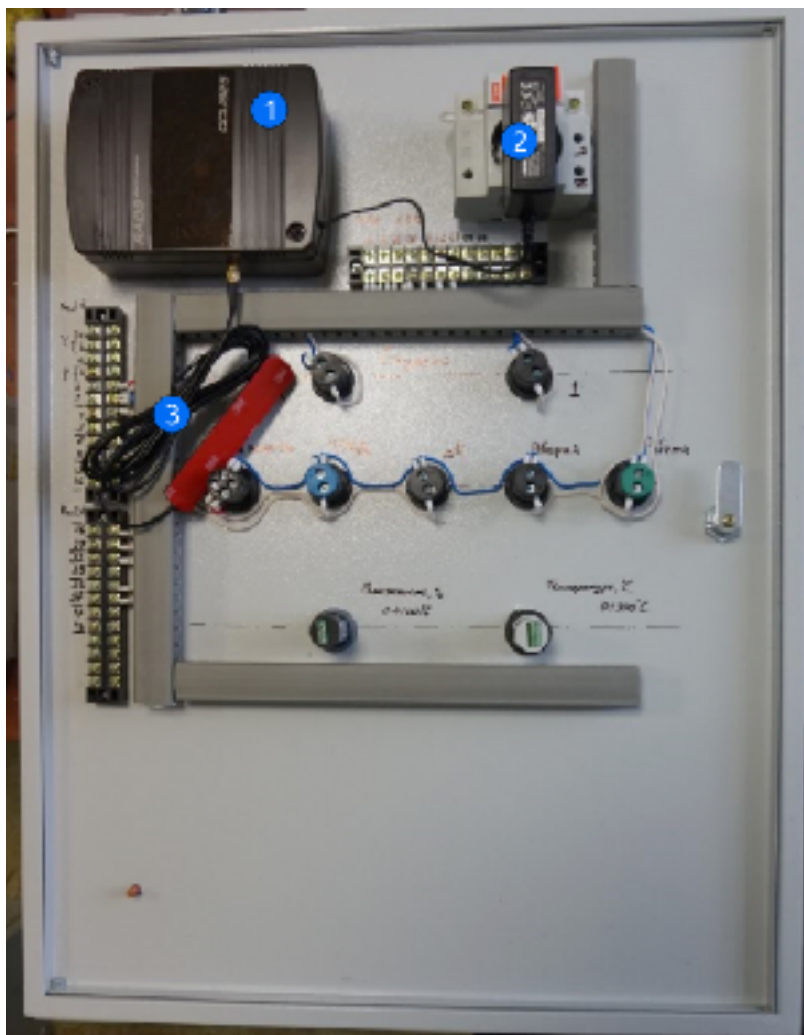
Рис.12. Дверца шкафа управления с внутренней стороны.
